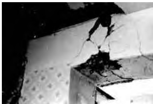
Рис. 6.1.8 Разрушение в торцевой части балки (согласно д-ру Шамилю Хакимову)
