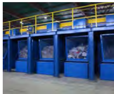
図 2.9.1 固形廃棄物処理プラント
