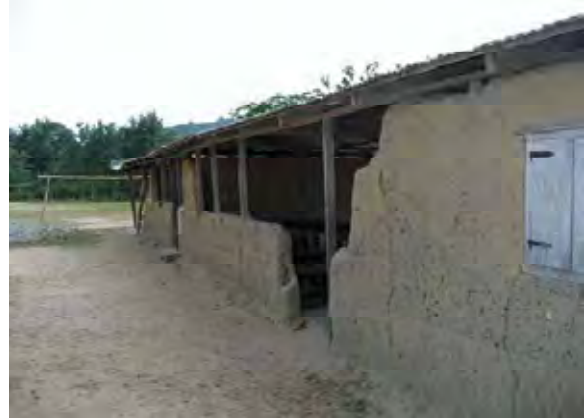
AS5 メソマゴール小学校 土ブロック積壁が一部崩れ危険な校舎
