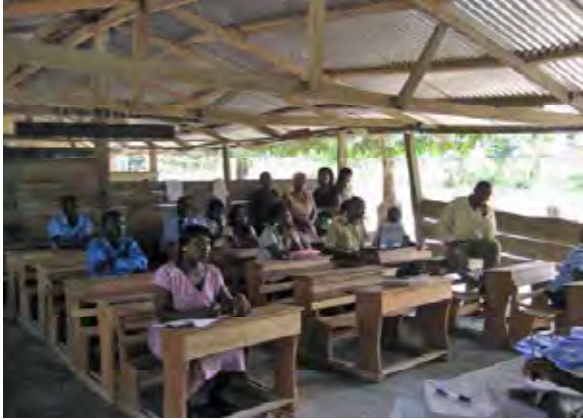
AS1 アセドウビアセプレスビル小学校 丸太柱と梁が傾き危険な校舎
