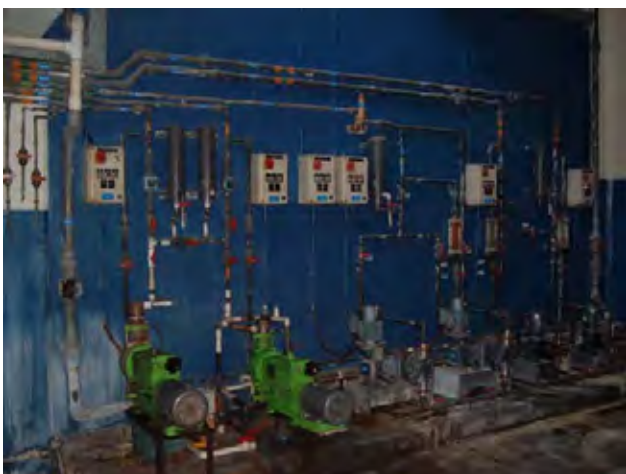
Mona 浄水場 硫酸ばん土、消石灰注入ポンプと配管: 比較的整然としている。
