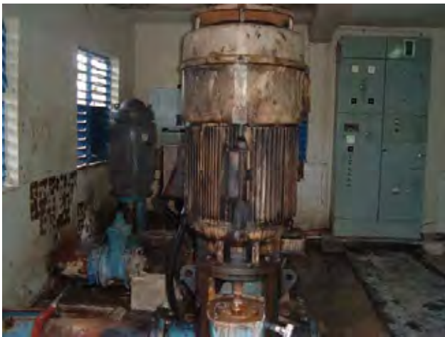
Iter Boreale 浄水場 配水ポンプ: 古いポンプを維持管理しながら使用されている。
