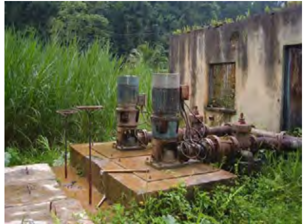
Niagara 浄水場 取水ポンプ: 古いポンプを維持管理しながら使用されている。
