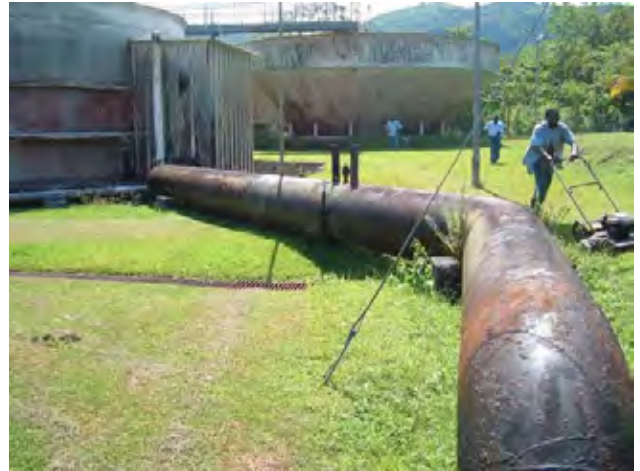
Bogue 浄水場 ろ過池と浄水池への配管： 鋼製配管の一部に錆が見られる。
