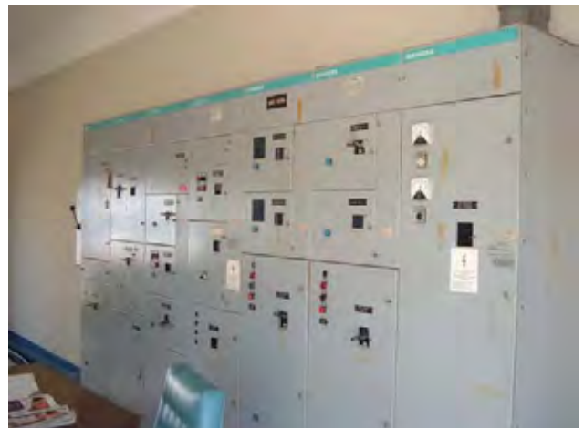
Bull Strode 浄水場 コントロールパネル： パネルは比較的良好に維持管理されている。
