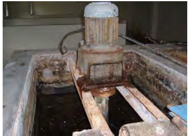
White River 浄水場 薬品攪拌機: 動くが相当錆が目立つ。
