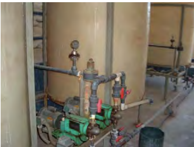
Bull Strode 浄水場 硫酸ばん土注入ポンプ： 高床上に設置されており腐食は見られない。
