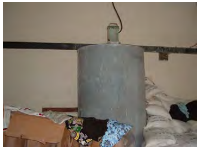
Hope 浄水場 破損攪拌機と乱雑な薬品貯蔵
