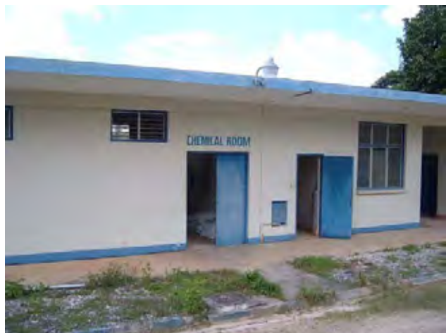
Niagara 浄水場 コンクリート製薬品倉庫: 構造物は比較的良好に維持管理されている。
