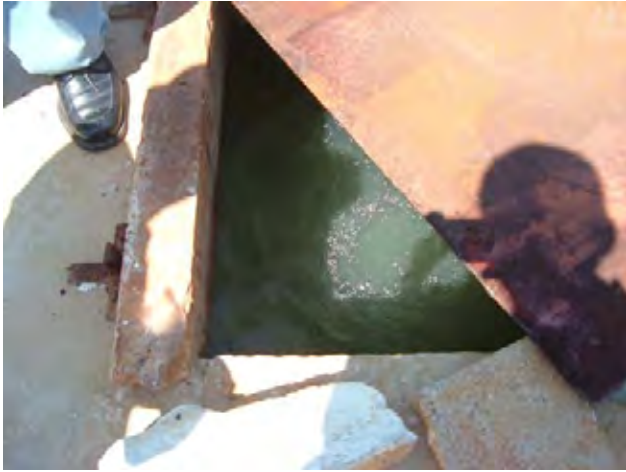
Old Martha Brae 浄水場 浄水池: 浄水池の水に幾分濁りが見られる。
