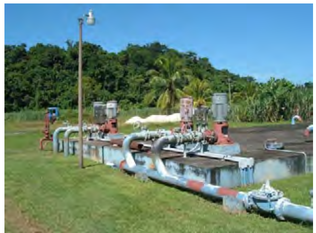
Bull Strode 浄水場 浄水池と配水ポンプ、逆洗浄ポンプ： 配管には防錆塗料が塗られている。
