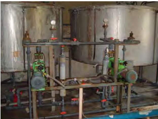
Bogue 浄水場 硫酸ばん土攪拌タンクと注入ポンプ： ポンプは架台の上に設置されており、腐食の防護防止上好ましい。
