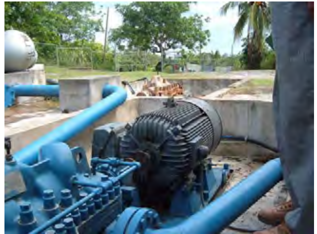
Agualta 配水タンク ポンプ カップリングの故障: 輸入品のため入手に時間を要している。
