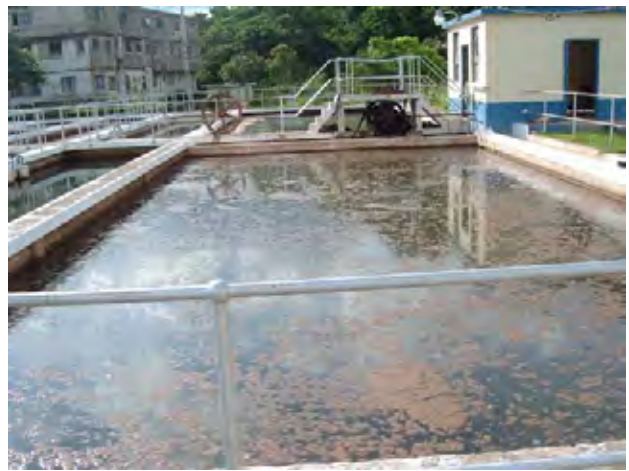
Constant Spring 浄水場 混和池 機械式攪拌: フロック形成が見られ、混和池の役割を果たしている。
