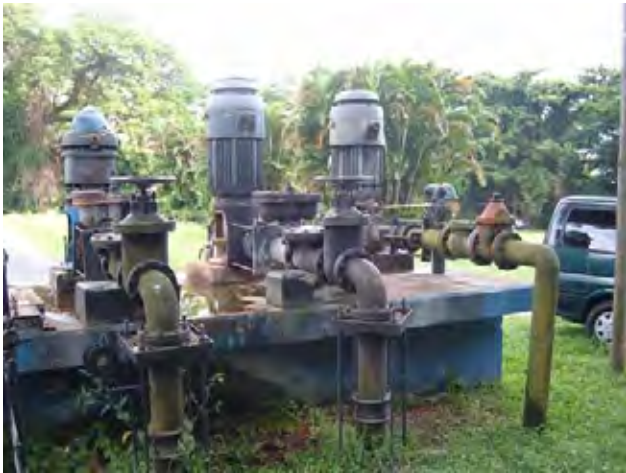
Constant Spring 浄水場 配水ポンプ 3 台 (2 台運転、1 台は予備): 維持管理は比較的良好である。
