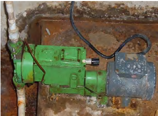
Niagara 浄水場 硫酸ばん土注入ポンプ: 据付部他に錆が目立つ。
