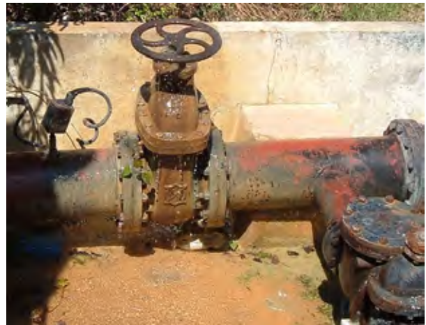
Old Martha Brae 浄水場: バルブからの漏水が放置されている。
