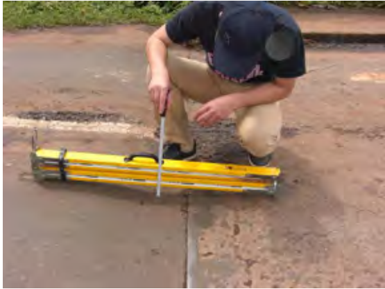
写真3-8 タンザニア側の取り付け道路 (橋梁端部より道路との段差: 6cm)
