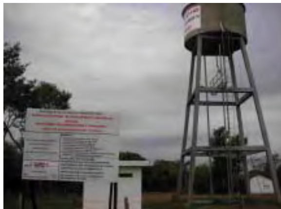
Tanque de distribución y oficina de control de pozo de San Librada, departamento de Misiones
