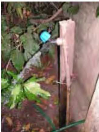
Canilla de distribución de cada vivienda en Antequera departamento de Itapúa Comunidad rural sujeto del programa de cooperación financiera no reembolsable "Programa de provisión de agua de la región oriental". Canilla ubicada en el patio de la casa. Además de agua corriente, tiene el pozo de perforación manual.
