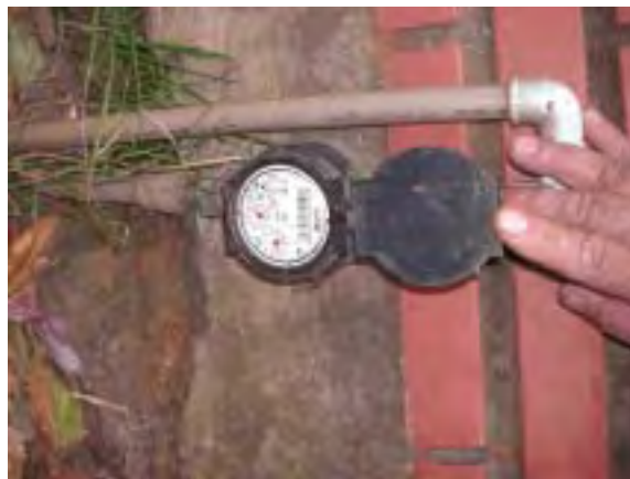
Medidor de agua de Antequera, departamento de Itapúa. Comunidad rural sujeto del programa de cooperación financiera no reembolsable "Programa de provisión de agua de la región oriental". Medidor de agua instalada con el patio de la casa. Esta comunidad tiene una tasa de instalación de 100%. Según comentario no son muchos los que superan la tarifa básica del mes (15m 3 ).
