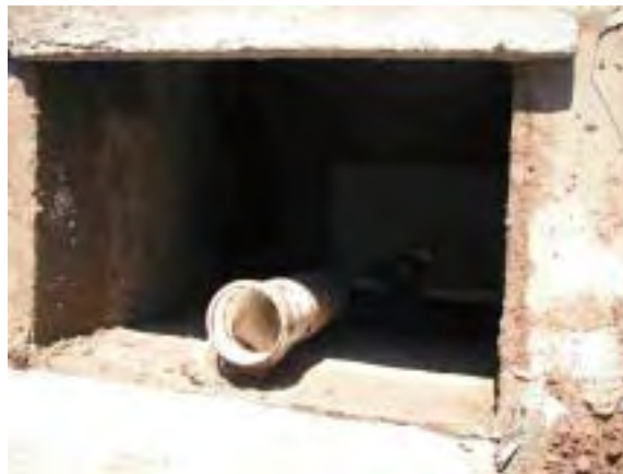
Estructura del tanque séptico de Nande Rogar departamento de Guairá Interior del tanque séptico. Las aguas residuales domésticas entran desde la parte superior, y sólo las aguas claras desbordan a la fosa de absorción situada en la parte inferior. En la foto se observa el tubo de entrada, y en el otro lado se encuentra instalado el tubo de salida, que se conecta a la fosa de absorción.
