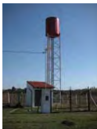
Tanque de distribución y caseta de control de pozo de Nande Rogara, departamento de Guaira.
