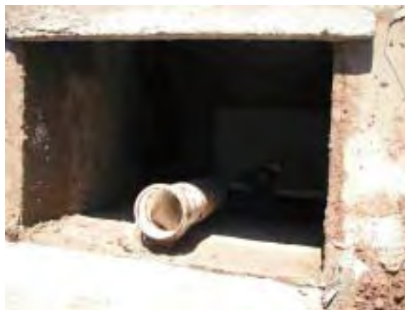
Estructura del tanque séptico de Nande Rogar departamento de Guair: Interior del tanque séptico. Las aguas residuales domésticas entran desde la parte superior, y sólo las aguas claras desbordan a la fosa de absorción situada en la parte inferior. En la foto se observa el tubo de entrada, y en el otro lado se encuentra instalado el tubo de salida, que se conecta a la fosa de absorción.
