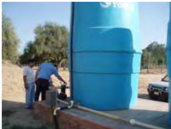
Ciudad de Filadelfia, departamento de Boquerón zor central del Chaco en la región occidenta Tanque ubicado al lado de la laguna. Se bombea a la comunidad indígena aledaña. Los pobladores trabajan muchas veces dentro de las plantas de la cooperativa menonita, y compran el agua.
