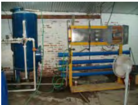
Ciudad de Filadelfia, departamento de Boquerón zor central del Chaco en la región occidenta La única aguatera privada dentro de la ciudad. La fuente de agua es un pozo y como tiene una alta salinidad, utiliza desalinizador de resina de intercambio iónico. Realiza la distribución a una parte de la zona y vende en botellas.
