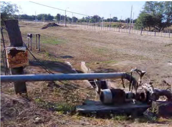
Filadelfia市 送水ポンプ
