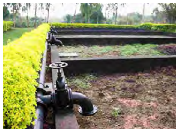
Villela下水処理場
