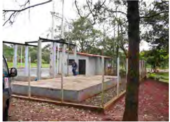
Este市 ポンプ場
