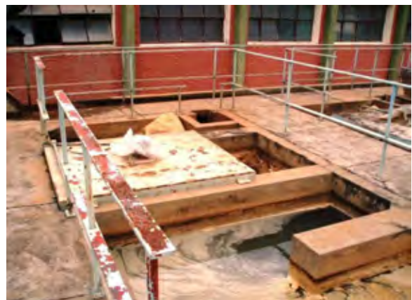
Villarrica市 薬品沈殿池
