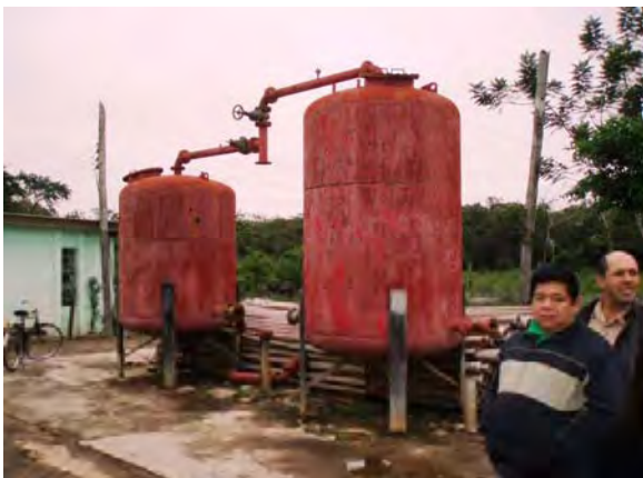
San Pedro市 水衛生委員会による浄水場 過去に使われていたプラント
