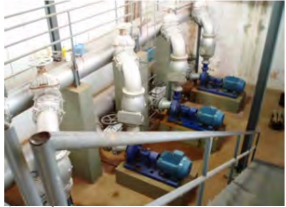
Caaguaz市 送水ポンプ
