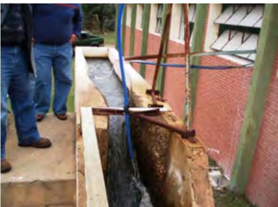
Villarrica市 着水池兼凝集剤混和池
