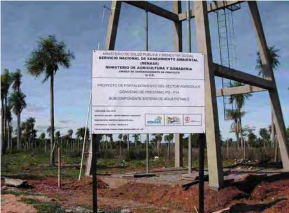
Paraguari県 Isra Alta村 円借款「農業部門強化事業II」により建設中の高架式配水池 水源が確保されておらず工事が中断している
