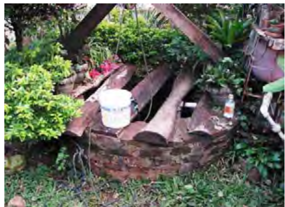
Caaguazu県 Quinta Neluye村 未給水村落 浅井戸
