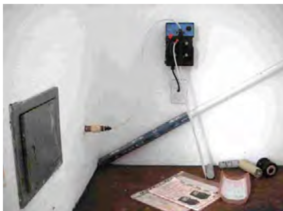
Caaguazu県 Calle Guazú村 塩素注入器 (IDB)
