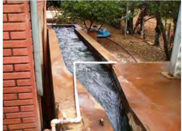
Encarnacion市 着水井兼凝集剤混和池
