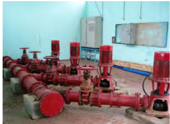
Tebicuary Mi 浄水場 (Villarrica市 Conl.Obeide市) 送水ポンプ 浄水場からVillarrica市とConl.Obeide市に送水されている
