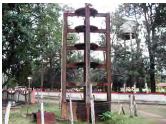
Neembucu県 Guas Cua村 世銀(BIRF4)の支援によって建設された高架式配水池と鉄分除去のためのエアレーション装置
