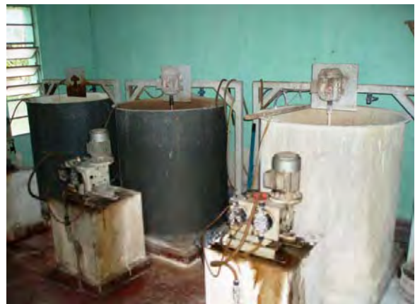
San Pedro市 凝集剤攪拌機(左)とアルカリ剤攪拌機(右)
