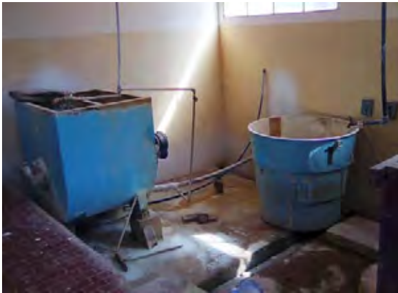
Concepción市 凝集剤攪拌機
