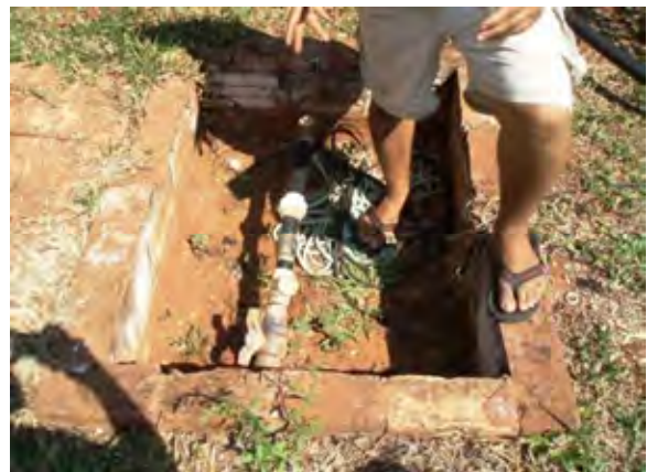
Koeju 民間水道業者 配水管
