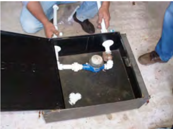
San Estanislao市 水道メータとメタル製ボックス
