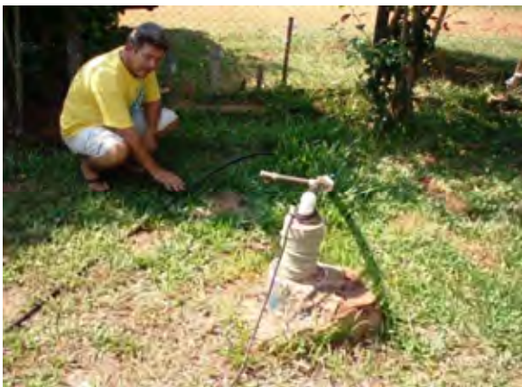
Koeju 民間水道業者 屋外給水栓
