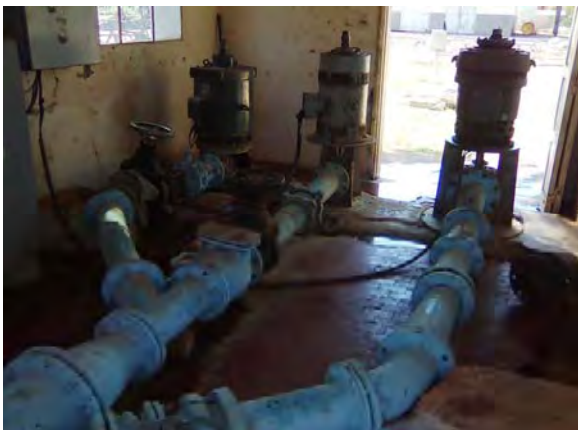
Concepción市 送水ポンプ
