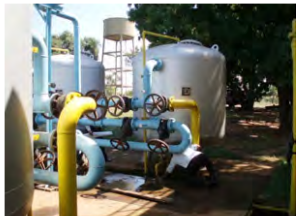
Caacupe市 浄水処理施設
