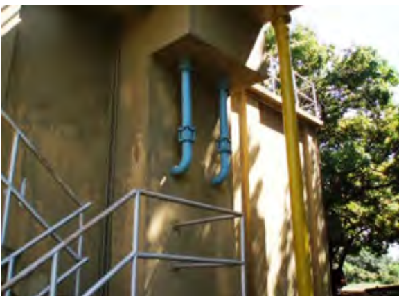
Caacupe市 浄水処理施設
