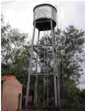
Caazapa県 San Jose Me村 大統領夫人基金の支援によって建設された高架式配水池
