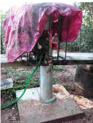
Paraguari県 IDBによって掘削された井戸 揚水量が不十分のため破棄された代替水源が確保されていないため村落側ではポンプを設置し使用している
