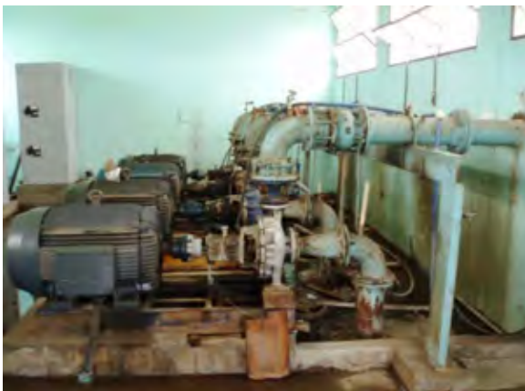
Villarrica市 送水ポンプ
