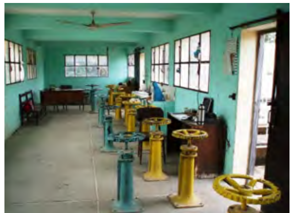
Villarrica市 急速ろ過池管理バルブ
