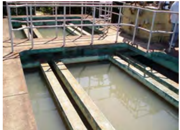
Caacupe市 急速ろ過池
