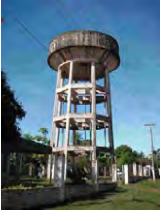
Paraguari県 Qinindy村 世銀(BIRF1)の支援によって建設された高架式配水池
