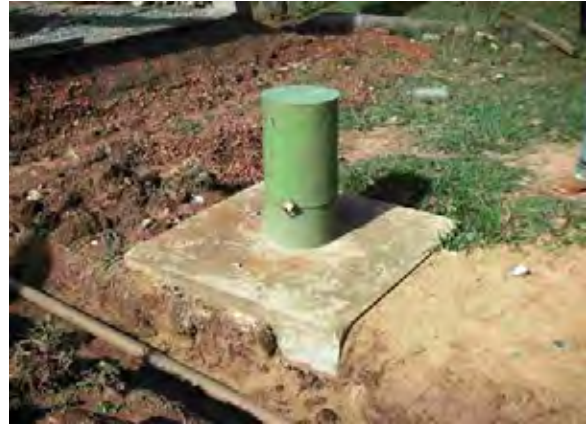
Paraguari県 Isra Alta村 円借款「農業部門強化事業II」により建設中の井戸 揚水量が不十分のため破棄された
