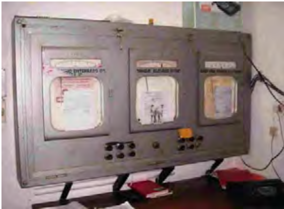
Pilar市 貯水管理盤
