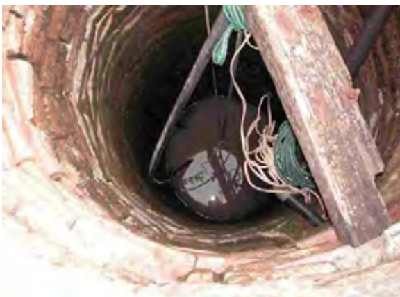
Caaguazu県 Caraudayty村 未給水村落 小学校内にある浅井戸
