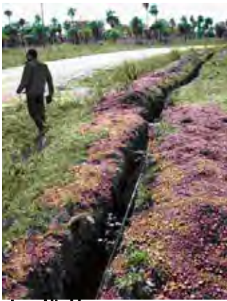
Paraguari県 Isra Alta村 円借款「農業部門強化事業II」の支援で住民側によって敷設された配管 水源が確保されておらず工事が中断している
