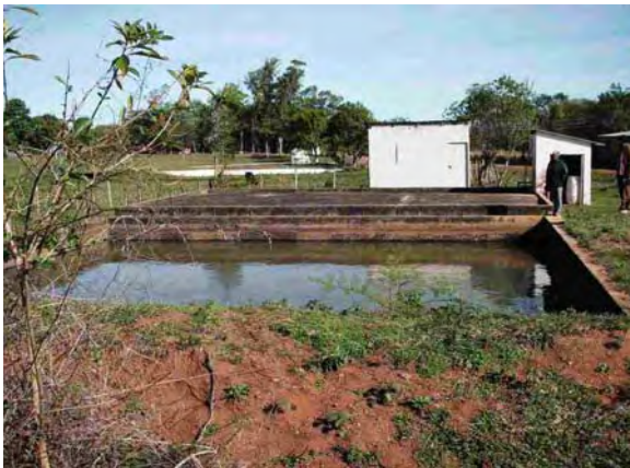
Paraguari県 Qinindy村 沈砂池 世銀(BIRF1)対象村落であるが、人口の増加に対応するため、表流水を取水している。
