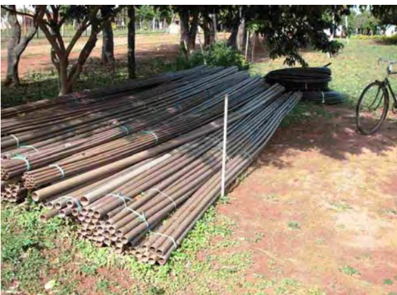
Paraguari県 Isra Alta村 円借款「農業部門強化事業II」の対象村落 配管材は住民側に供与されているが水源が確保されておらず工事が中断している
