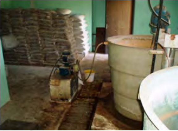
Caacupe市 凝集剤攪拌機
