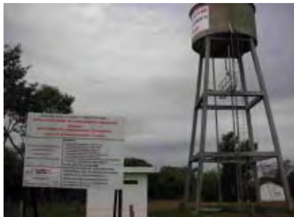
ミオネス県 Santa Librada 配水池及び井戸制御建屋
