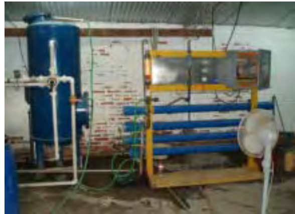
西部Central Chaco ホケロン県 Filadelfia市 市内に一軒ある民間の水道事業者。水源は井戸で塩分濃度が高いため、イオン交換樹脂による脱塩装置を使用している。一部の区域へ配水するとともに、ボトルで販売している。
