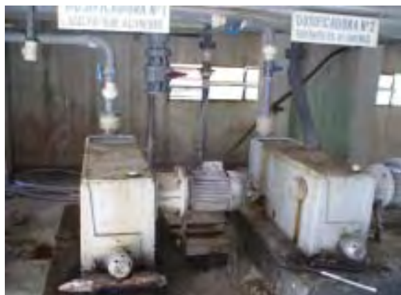
アスンシオン首都圏 Viñas Cué浄水場 薬品注入器。老朽化して、調整が困難である。
