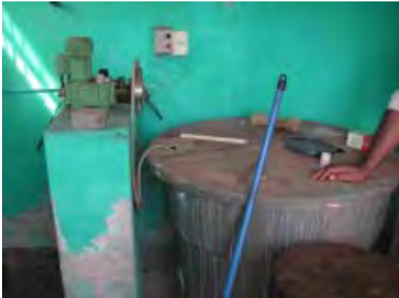
イタプア県 Chaipé 塩素注入器 無償案件「東部地域給水整備計画」日本側建設 日本側で設置した塩素注入器と調整用タンク。使用されていない。
