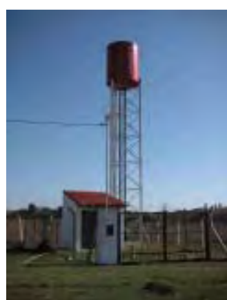
グアイラ県 Nande Rogara 配水池及び井戸制御建屋
