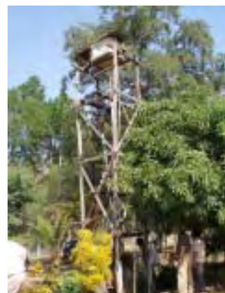
コルディジェーラ県 Caacupe 個人用高架水槽 既存水源は浅井戸で、ポンプで高架水槽に汲み上げている。この村落では、深井戸を掘削済みで、送配水管の設置を市役所へ要請している。
