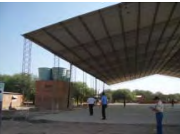
西部Central Chaco ホケロン県 Filadelfia市 草の根無償によるAljibes。一部の貯留タンクの蓋がない。接続の管が壊れている。フィラデルフィア市周辺では、メノータ組合がインディヘナ村落の責任者には維持管理を促しているという。
