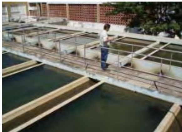
アスンシオン首都圏 Viñas Cué浄水場 Degremont浄水場側のフロック形成池 浄水場の容量不足から、維持管理のための時間が確保できない。結果として、傾斜版がない状態が放置されている。
