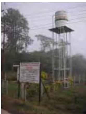
グアイラ県 Teniente Bogado 配水池
