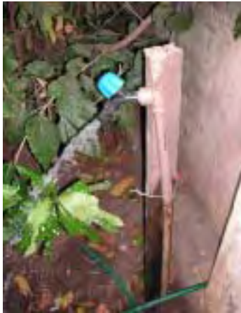
イタプア県 Anteguera 各戸配管された蛇口 無償案件「東部地域給水整備計画」対象村落 民家の庭先にある蛇口。給水施設のほか、手掘井戸もあわせて所有している。
