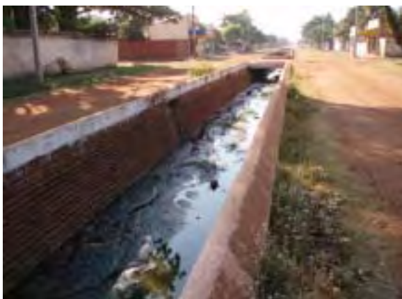
東部 Concepción県 Concepción市 ESSAPの下水管がある地区。 市内の雨水用排水路。污水管が接続されており、問題となっている。
