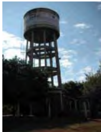
イタリア県 Chaipé 配水池
