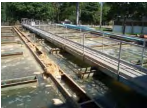
アスンシオン首都圏 Viñas Cué浄水場 Micro Floc浄水場側のフロック形成池、薬品沈殿池定期的な清掃がなされていない。また、生産量を増やすため、フロック形成池を改修したが、うまく機能していないように見受けられた。
