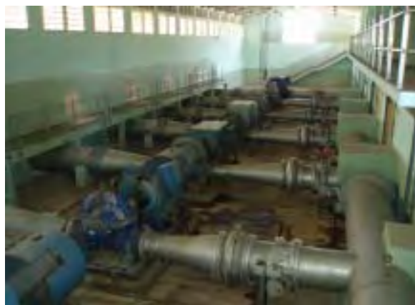
アスンシオン首都圏 Viñas Cué浄水場 送水ポンプ場。JBICプロジェクトで建設され、首都圏の送配水に貢献している。
