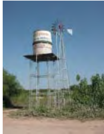
ホケロン県(西部) Santa Helena タマルの風車及び貯水槽 2006年にSENASA-BIDによって建設されたタマルを構成する風車と貯水槽(10m 3 )。施設後部に水源である池(タマル)があり、風車の回転によって下部のピストンを動かすことで揚水する。配水池からは重力により村落中心部にある地下式貯水槽、衛生施設に分配される。
