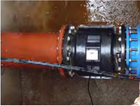
Zagoric ポンプ場で遠隔監視を試験的に導入するために設置した流量測定装置。
