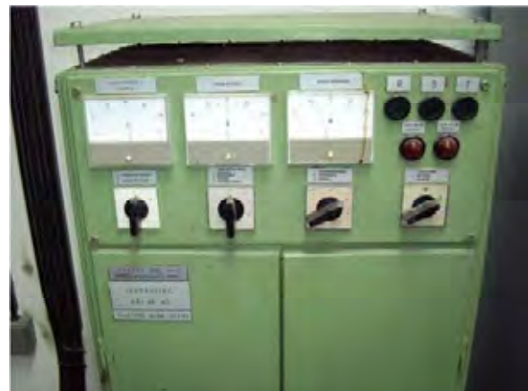
図 2-21 「新ポンプ場」用直流電源盤
