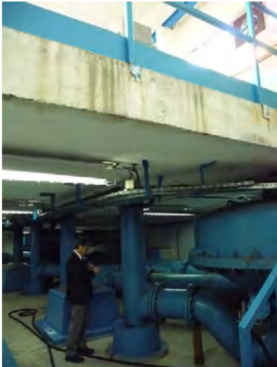
新ポンプ場内部。上のスラブにモーターとポンプが載っており、その下にポンプのシャフトが伸びている。右に伸びている青い管はポンプで吸い上げた水を送り出す吐出管。この下に湧水が導かれたポンプ井がある。
