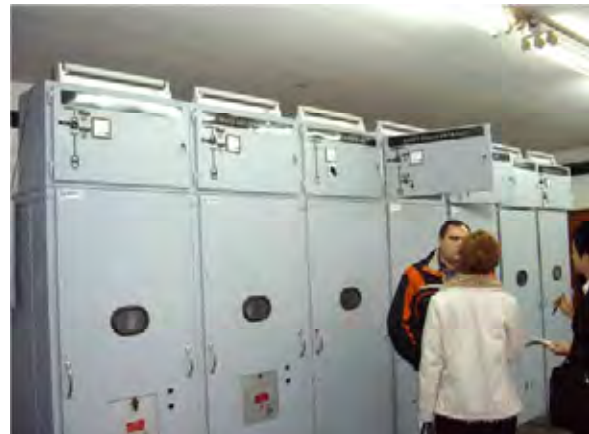
図 2-19 「新ポンプ場」高圧配電盤 (B+01 - B+07)
