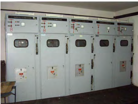
図 2-18 「新ポンプ場」高圧配電盤 (A+01 - A+05)
