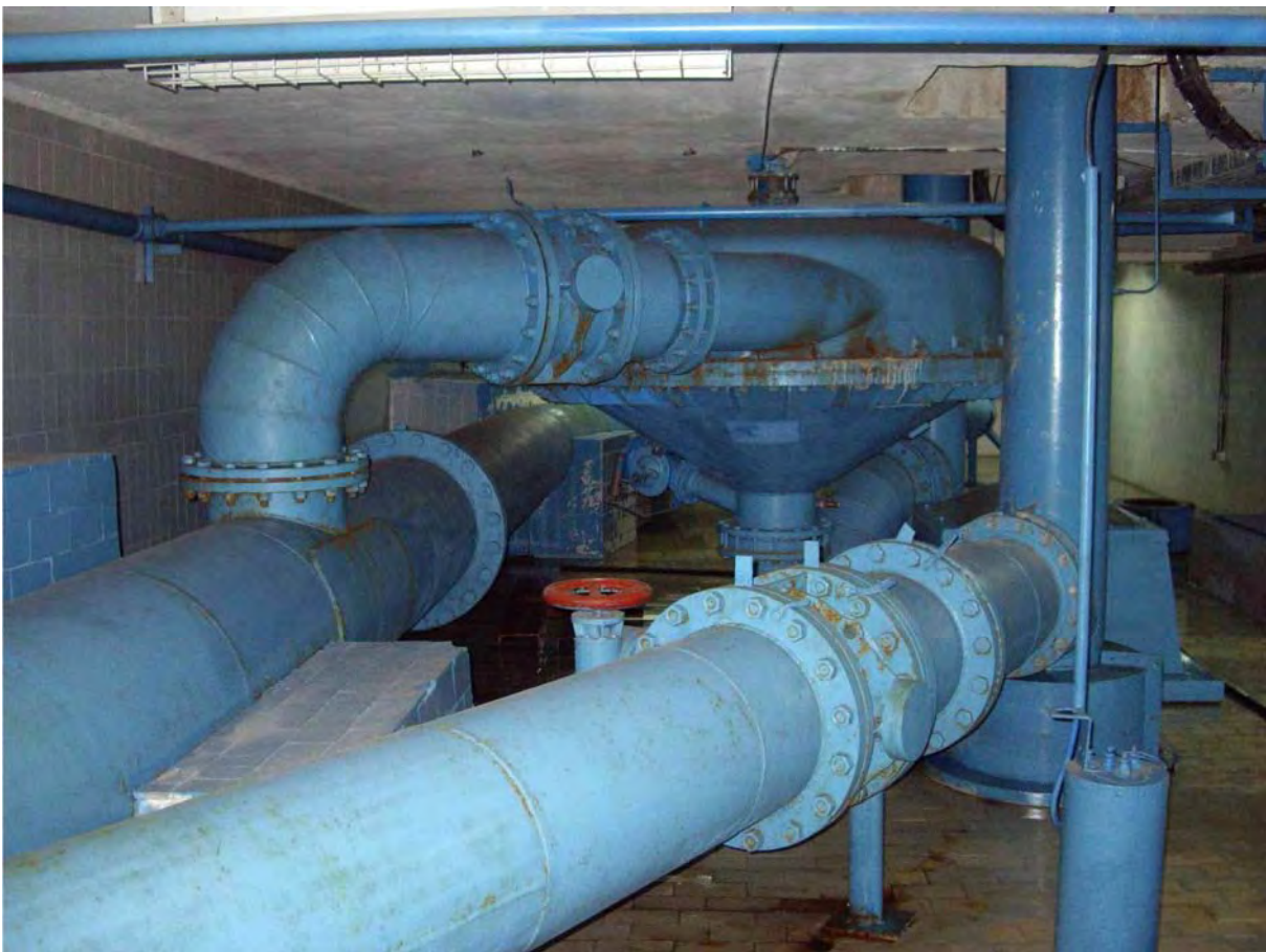
図 2-13 マレザ新ポンプ場ポンプ吐出配管
