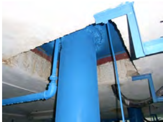
スラブに直接ポンプ及びモーターが据え付けられているため、建屋との共振が増大する原因となっている。
