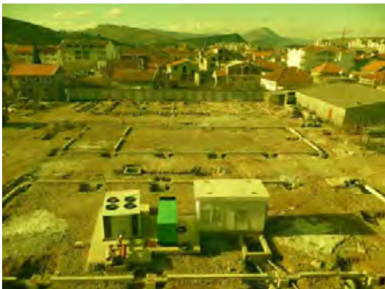
上下水道公社の敷地内で建設中の倉庫とラボ。3棟のうち写真の一番奥がラボになる予定。2009年完成予定。
