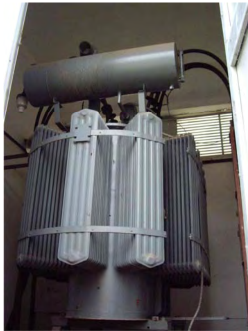
図 2-17 「新ポンプ場」用変圧器
