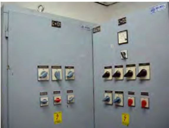
図 2-20 「新ポンプ場」低圧配電盤 (C+01 - C+02)
