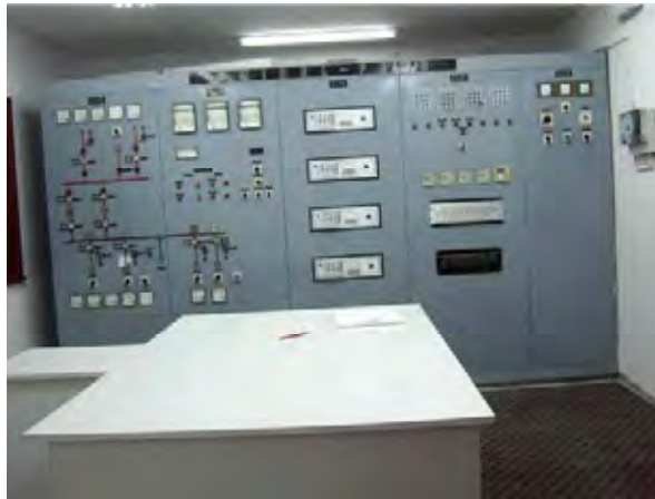
図 2-22 「新ポンプ場」ポンプ制御盤 (D+01 - D+05)
