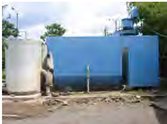
ゴワ県 PDAM 本部敷地内にあるトンポバラン浄水施設（水源：ジェネベラン川、浄水能力：40 リットル/秒、稼動開始年：1987 年）。
