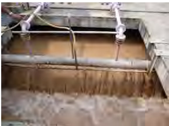
ソンバ・オブ浄水場の原水。ホースからつながっている細い管は、崩壊後に薬注量が増えたため水道公社が独自に増設した凝集剤注入装置。
