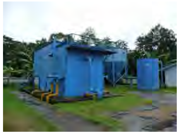
水道公社事務所敷地内の浄水施設。 手前は 20 リットル/秒、奥は 10 リットル/秒。
