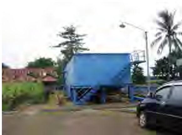
マロス県パットントンガ浄水施設（水源：レコパンチン川、浄水能力：50 リットル/秒、稼動開始年：2002年）。
