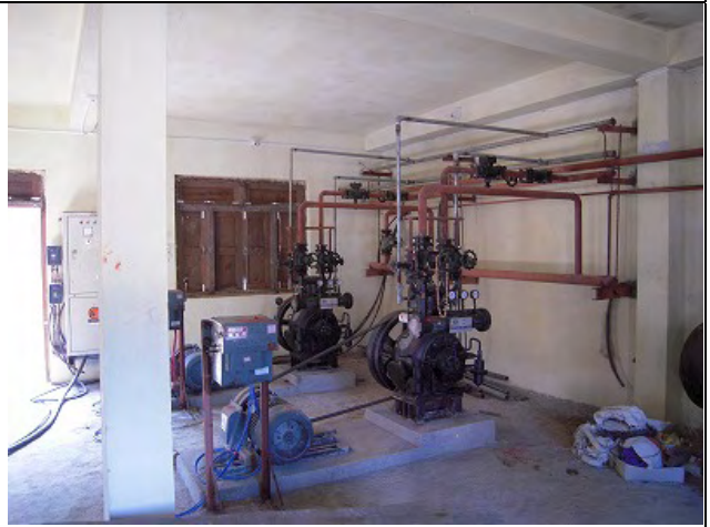
草の根無償で供与されたジュナール冷蔵施設の冷蔵施設。
