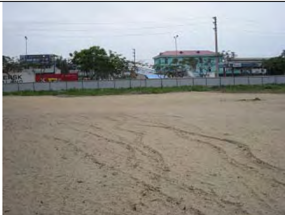
写真—7 ハイフォン港 X 線検査場 地盤改良工事後 (南西方向)
