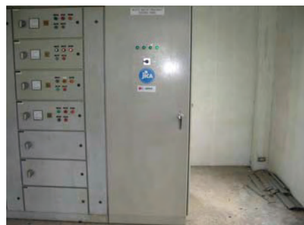
自動タイマー制御パネル
