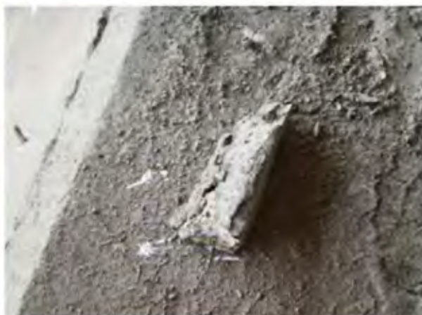
橋版から剥離したコンクリート片
