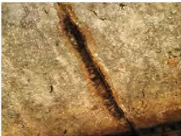
橋版裏側の損傷状況
