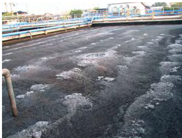
図 3.3.2-23 バンドン近郊の染色企業排水処理曝気槽
