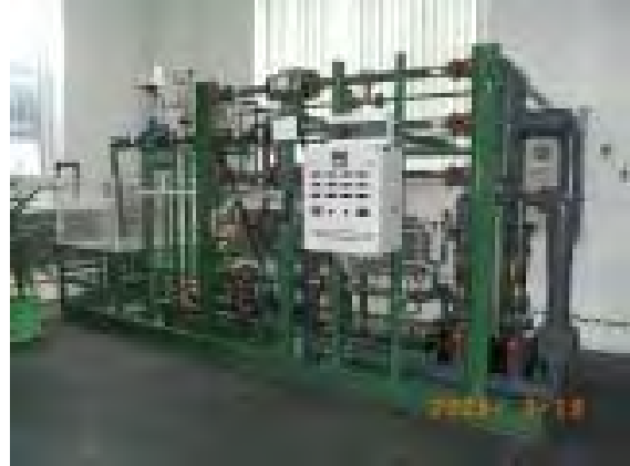
装置の右部分にインバータのない新ポンプ、関連配管が追加されている
