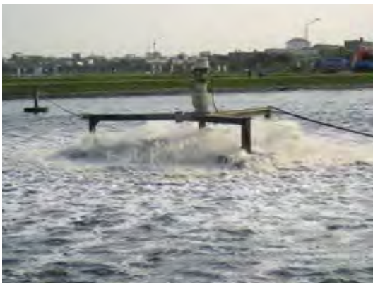
Рис. 3.1.24 Поверхностный аэратор в аэрируемом пруде
