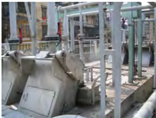
Рис. 3.1.10 Трубопроводная обвязка для отвода неприятных запахов от решеток
