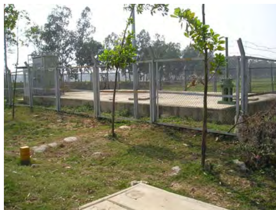
Рис. 3.1.5 Насосная станция, расположенная рядом с КОС
