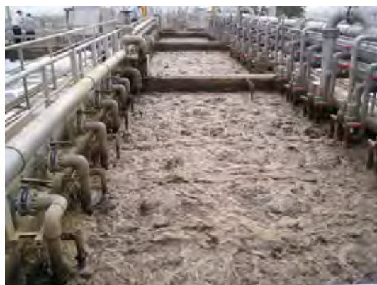
Рис. 3.1.28 Реакционный резервуар, в котором применена технология МБР (общий вид)
