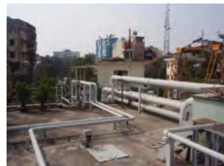
Figure 3.1.8 Kim Lien WWTP
