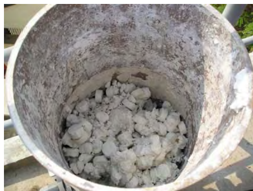
図 3.1.13 固形塩素による消毒設備
