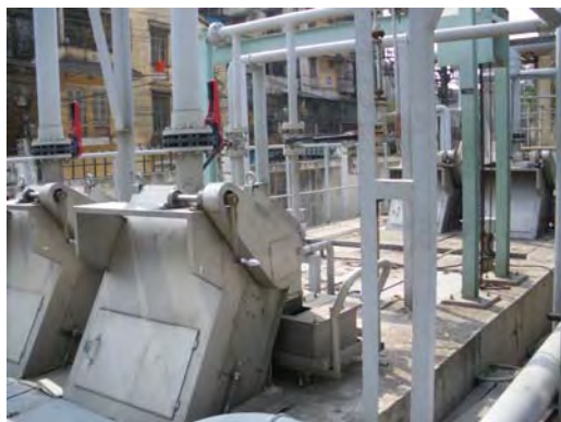
図 3.1.10 スクリーン設備の脱臭配管
