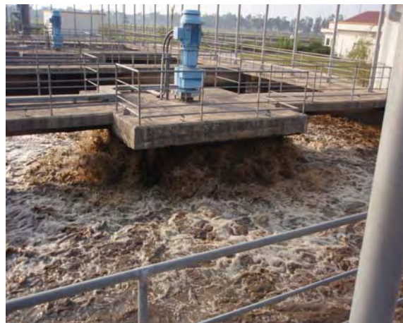
図 3.1.4 北タンロン処理場の表面曝気方式
