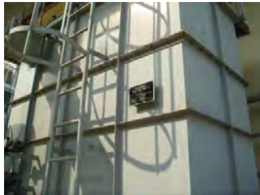
図 3.1.11 活性炭を用いた脱臭装置
