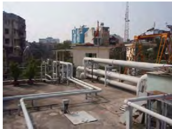
図 3.1.8 キムリエン処理場全景
