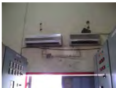
電気室のエアコン
