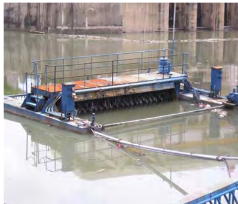
図 2.1.7 設置されている曝気機
