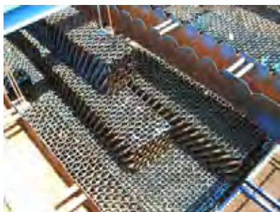
沈殿池の傾斜板
