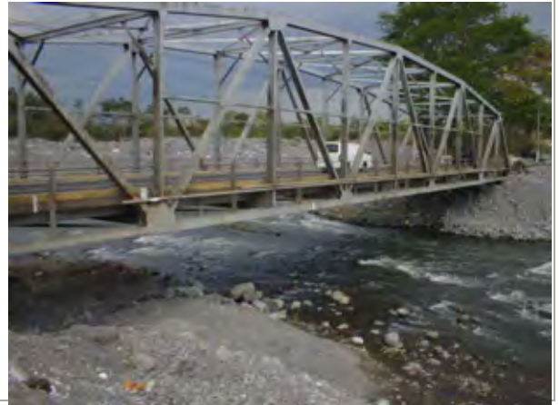
2. サマラ川 CCA橋 (CA2)地点の河床高は、1954年架橋当時 より5~10m上昇しており、当地点周辺での洪水 氾濫が頻発している。
