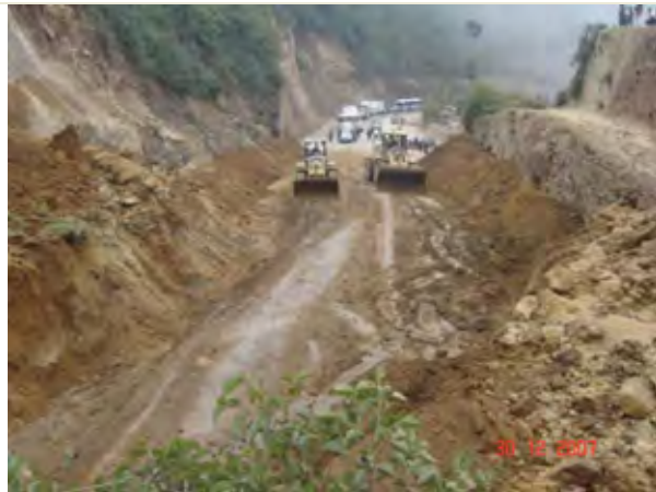
9. CA1の土砂崩れ 2007年12月に切り通し部で発生し、廃土作業が 行われた。 (出典：MICIVI DGC UNIRIOS)
