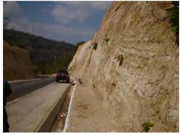
8. CA1 CA1側面の掘削法面は対策が不十分で、土砂災 害を頻発させている。
