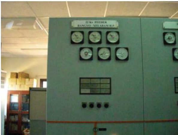
Bang Yo -Selabam フィーダ保護制御盤 今回の拡張に合わせ、計器類を交換する必要があるが、EDLにて実施する計画である。
