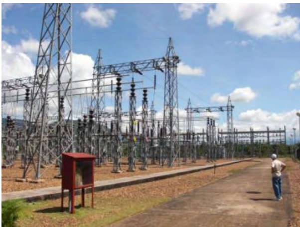
115 kV ヤード。手前側が 115 kV ヤード、一番奥が 22 kV ヤード。
