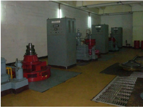
1～3号発電所内部。奥から1, 2, 3号機。手前の3号機は故障停止中。
