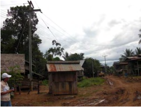
配電線。世界銀行の SPRE プロジェクト（現在は REP）により設置された配電設備。Xeset 1 発電所のある東側より延伸されている。
