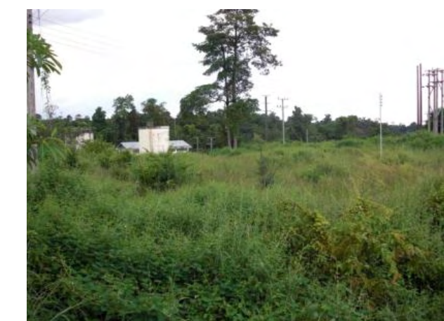
送配電線路。セラバム発電所の発電電力は所内開閉所からセドン川を横断して西側へ送配電される。東側は未電化集落が幾つか存在するが、現状ではセラバム発電所から配電線を延伸する計画はない。5号機拡張案ではこのスペースに導水路を通す計画である。
