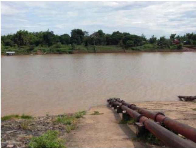
灌漑ポンプ。ディーゼルポンプが設置されているが、石油価格高騰により停止を余儀なくされているものが多く、電気ポンプへの交換を望む声も聞かれた。
