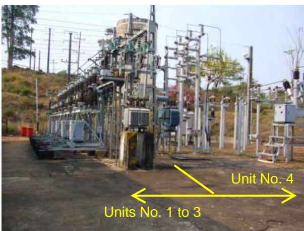
所内開閉設備。左が1~3号機側、右が4号機側。今回の拡張工事により全て撤去し、新設する計画である。
