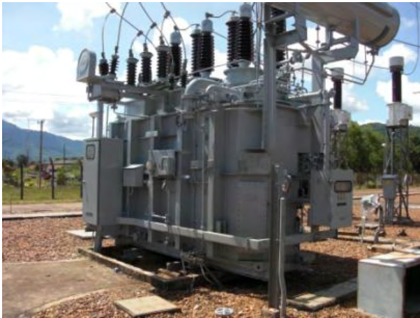
115/22 kV 変圧器。容量は 25 MVA。日本のダイヘン製。
