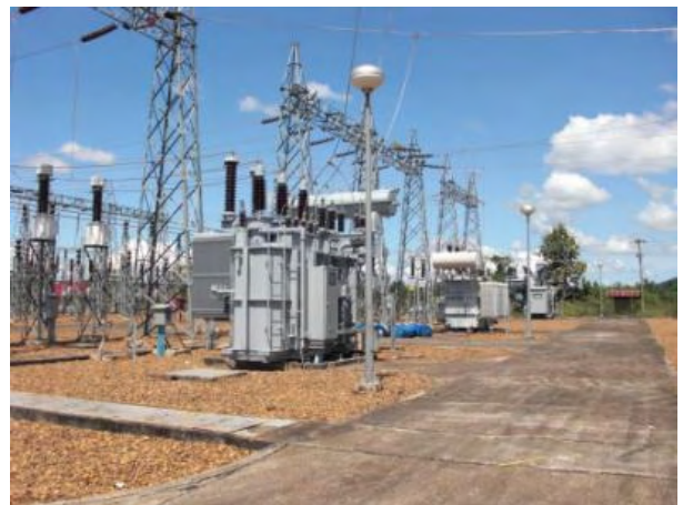
115/22 kV Tr と 115 kV ヤード。115/22 kV Tr が 2 機。右手が 22 kV ヤードとなる。
