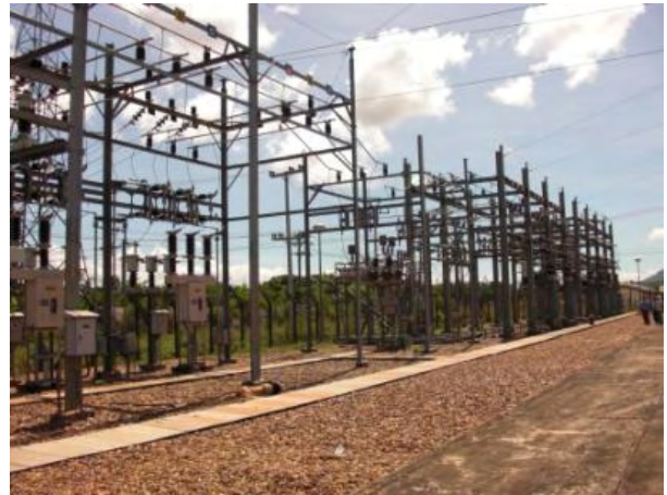
22 kV ヤード。22 kV はセラバムも含め、8 フィーダ。
