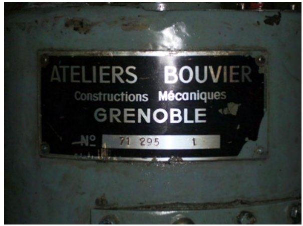
フランス Bouvier 社製発電機。製造会社が存続しておらず、スペアパーツの確保など修理が困難な状況。
