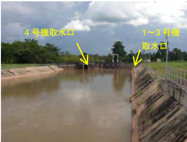
主取水路。2004年にEDLによりスクリーンと併せて改修された。5号機拡張に合わせた仕様となっている。それ以前は蛇籠による取水路であり、壁面の崩壊や排砂の不備により発電所の稼働率が低下していた。
