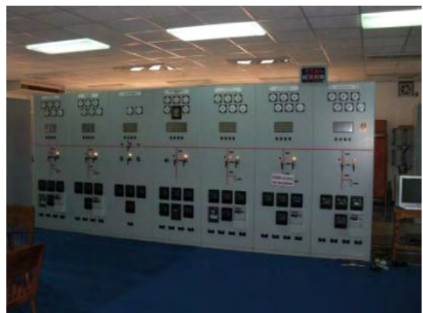
保護制御盤。一番左がセラバムフィーダのもの。
