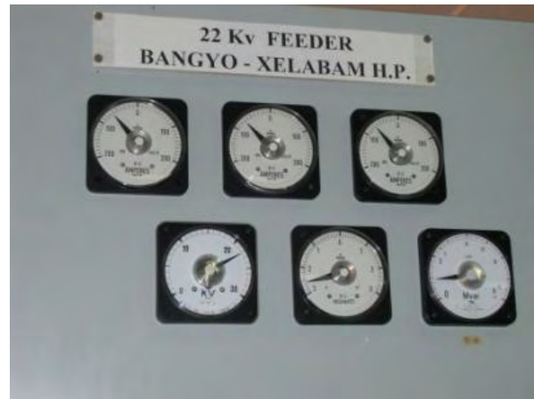
Bang Yo -Selabam フィーダ。当日（10/22）は、セラバム発電所→Bang Yo S/S の潮流であり、電流計（上の3つ）の針は左に振れている。まだ、出力は2.5 MW 程度を指している（下段中）。乾季には Bang Yo→Selabam の潮流となる。
