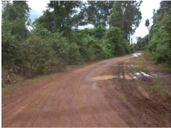
不陸部。プロジェクト開始前にはEDLにより補修される予定。
