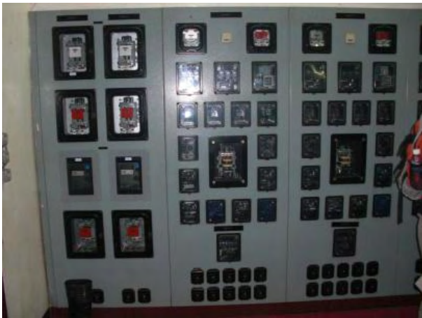
制御盤。アナログ式のもので運転データは EDL 職員が手書きにて記録。
