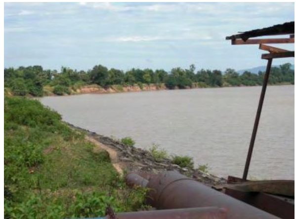
セドン川河川浸食部。発電所上流部のところどころに河川の浸食箇所が見られ、発電所に土砂の流入があるものと想定される。
