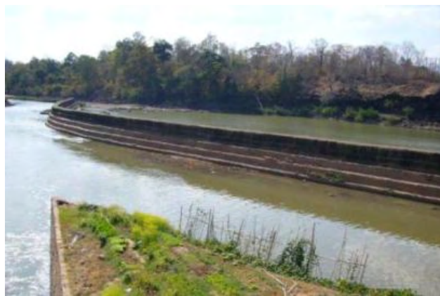
補修前の導流堤。2006年2月EDL撮影。
