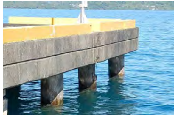
アサウ埠頭 棧橋 潮位計設置候補地 コンクリート製支柱の老朽化が進んでいる
