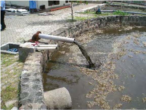
(3) OD 槽、ローター、汚泥返送ピット (写真 6~11)
