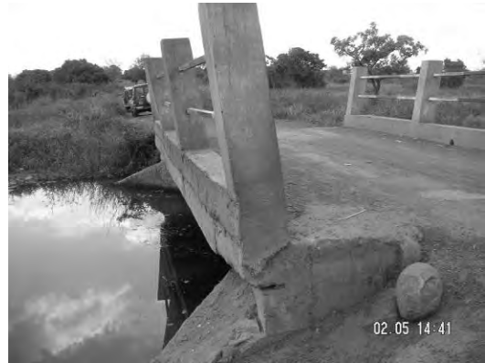
県道にかかる橋。取り付け部分の土手が崩れ落ちている。Pader 県
