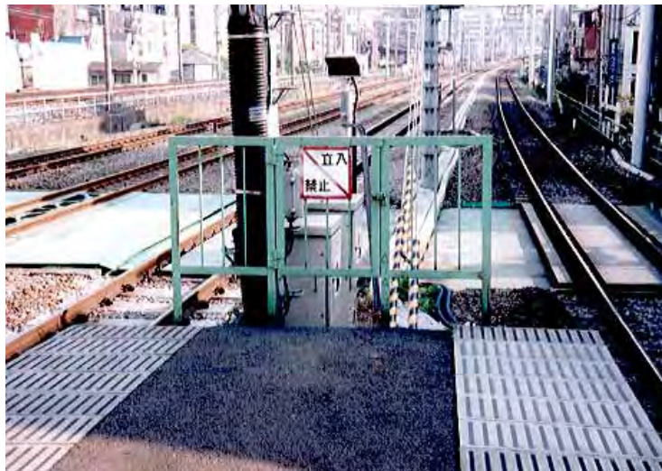
Ảnh 38.2 Hàng rào chống ngã cho hành khách ở phía cuối ke ga
