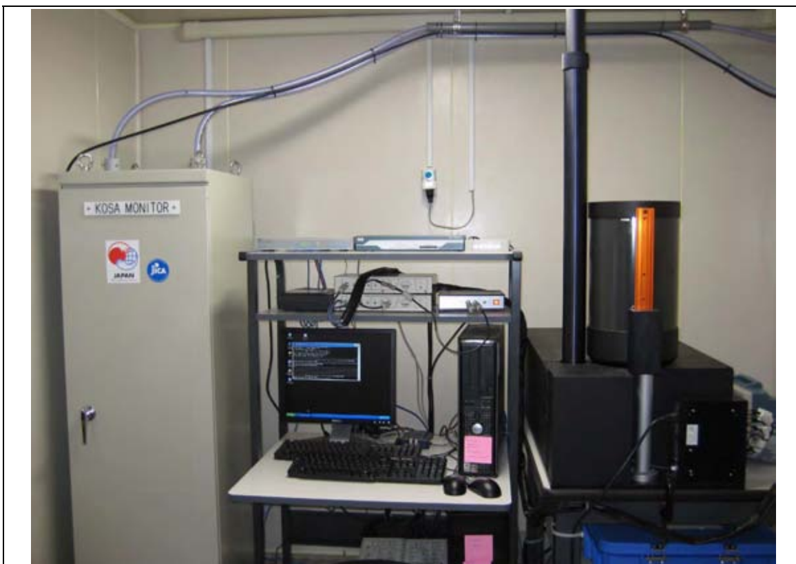
ザミンウッド設置完成（コンテナ内部の機材）：2007年8月18日
