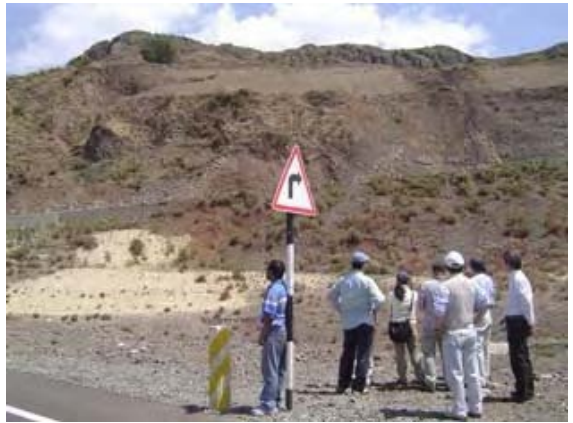
ゴハチオン側斜面地すべり。Sta.2～5より。 Sta.2上方の地すべり斜面を望む。
