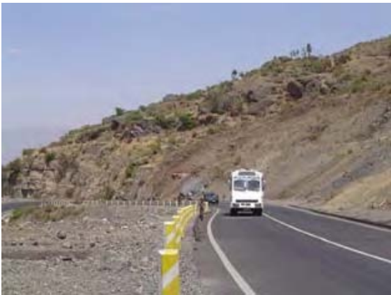
ゴハチオン側斜面地すべり。Sta.5
