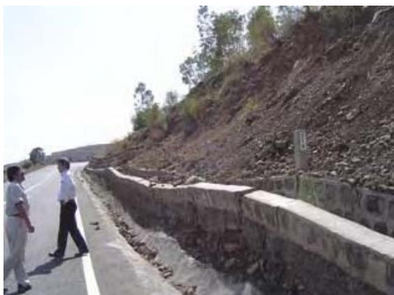
デジェン側斜面地すべり。Sta.26～28
