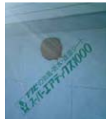
屋外側の排気口を 目張りしている例
