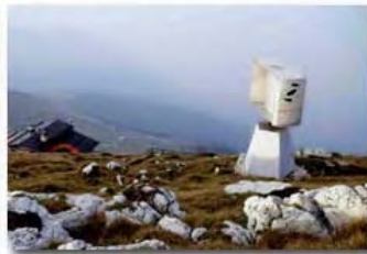
避難山小屋電源 イタリア
