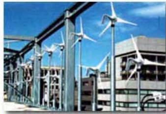
都市部小型ウィンドファーム 東京都永代橋 (計10kW)
