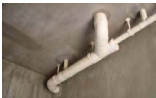
水廻りの天井（上階住戸の排水管がある）
