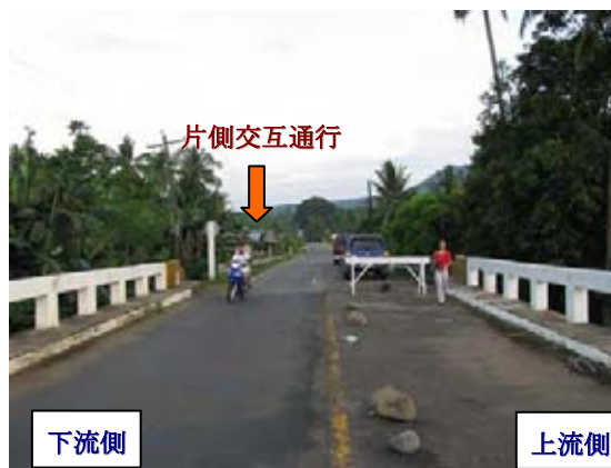
写真-2：上流側の橋梁主桁・横構損傷のため、安全を考慮して 2001 年台風ナンン以来、片側交互通行となっている。（ペノニ港方面を閉鎖）
