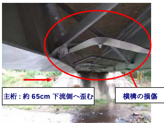
写真-3：フバンゴン橋梁。上流右岸側端部から 8m 付近の主桁、横構、下流左岸側端部から 4m 付近の横構に歪みが生じている。
