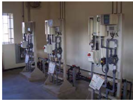
浄水場（塩素注入設備）
