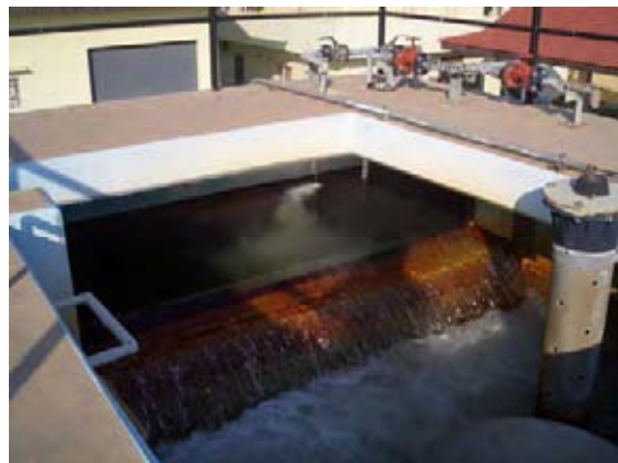
浄水場（着水井）
