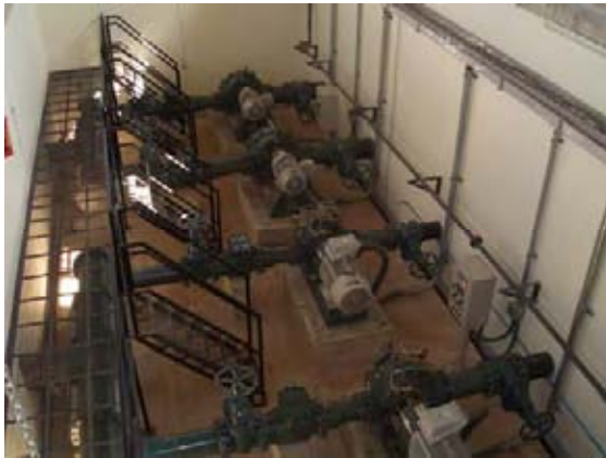
浄水場（ポンプ場）
