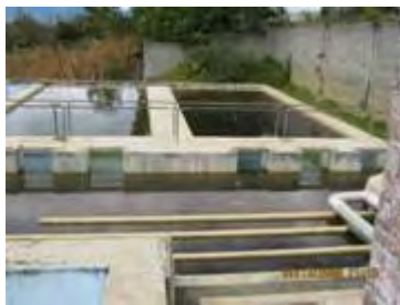
Planta de Tratamiento del Alcantarillado en Lamud
