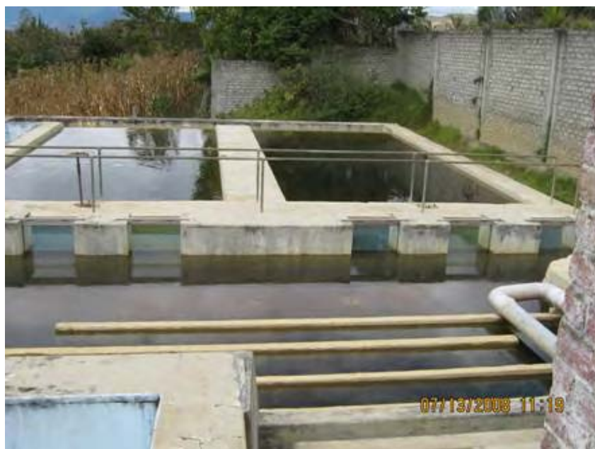
Planta de Tratamiento de Aguas
