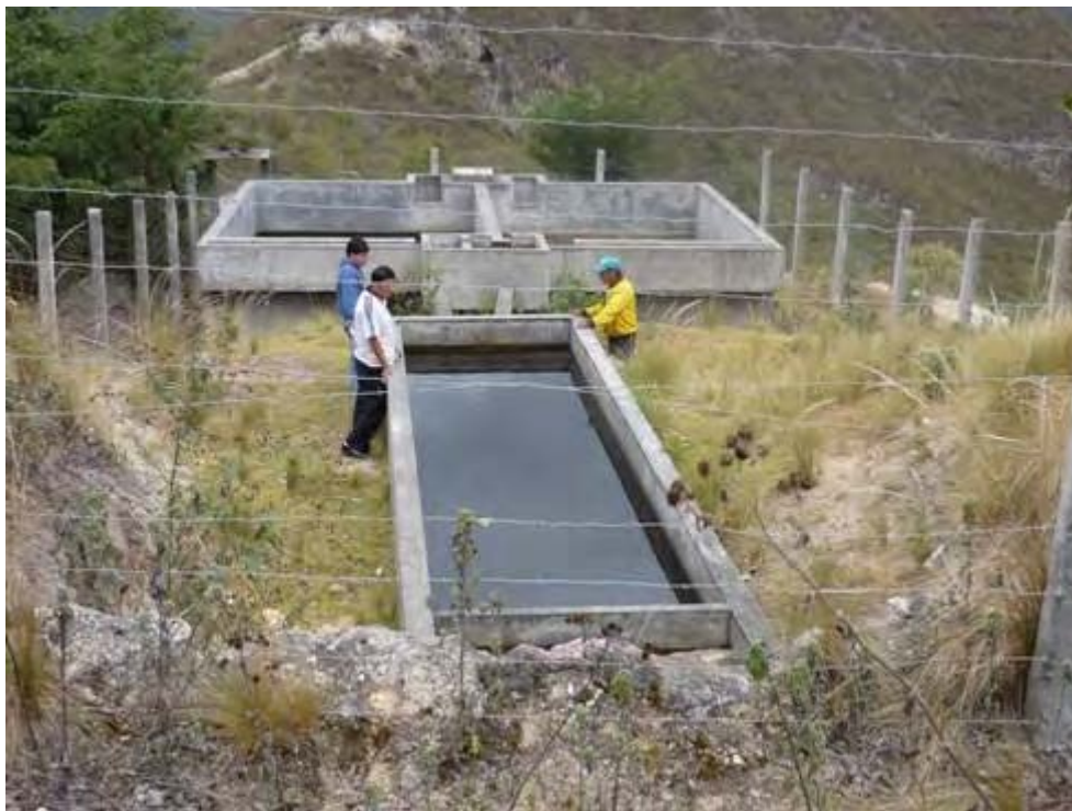
Planta de Tratamiento de Aguas – Sedimentador y Filtro Lento
