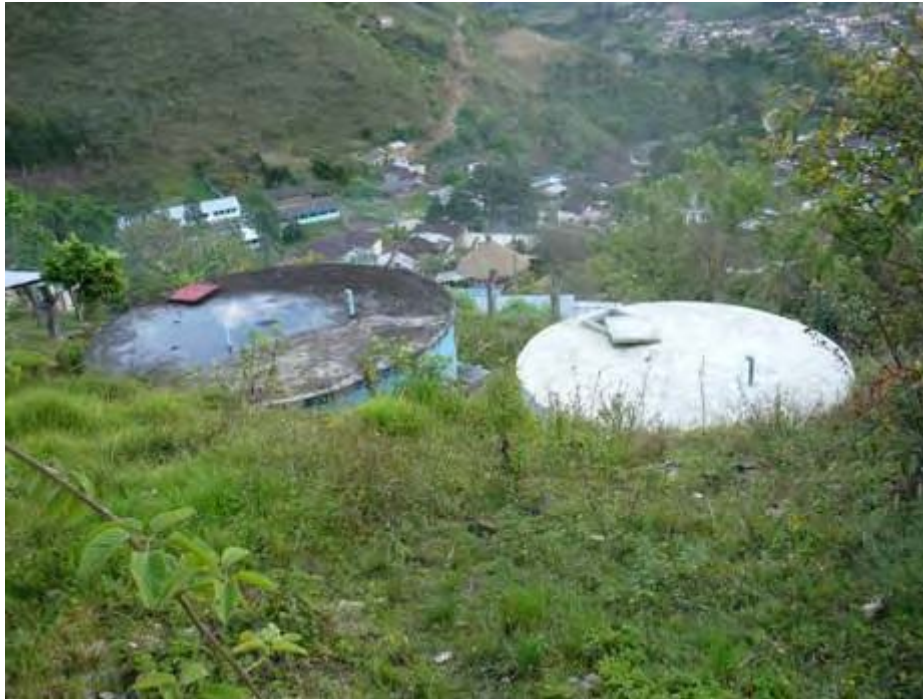
Reservorios Apoyados – 150 m 3 de capacidad por unidad
