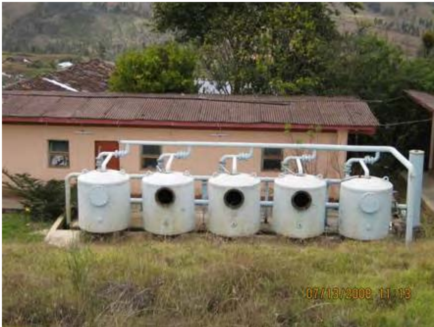
Filtros Patentados de la Planta de Tratamiento de Aguas
