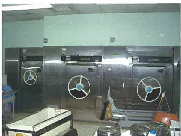
中央材料室の高圧蒸気滅菌装置。1996 年、わが国の無償資金協力により供与。良好に稼働中
