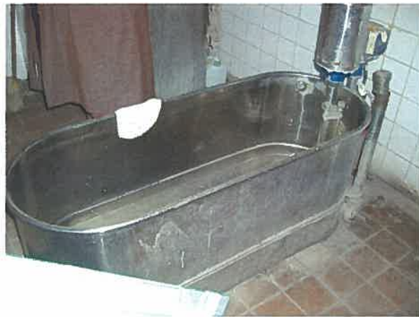
理学療法科に設置されている渦流浴装置、現在給湯配管が腐食しているため、使用されていない。
