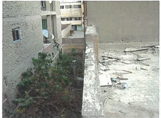
(Site 2) 既存建屋屋上から南側隣地との境界壁を見る (2) 左が小児病院に面している6階建てアパートの裏側。 正面奥が、東隣の公立語学学校の建屋と狭い校庭
