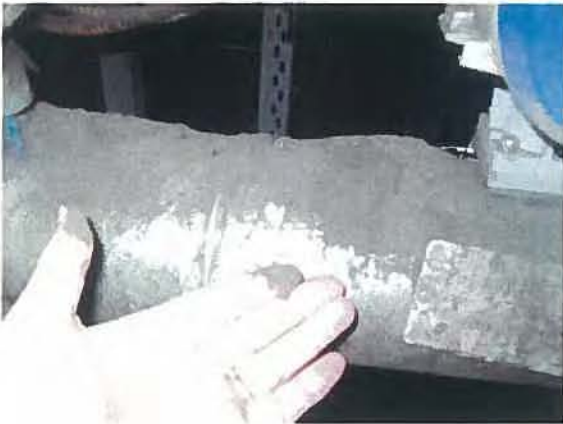
ボイラエリア配管への石炭灰積層
