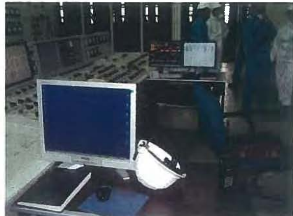
統制なき追設の制御室モニター画面
