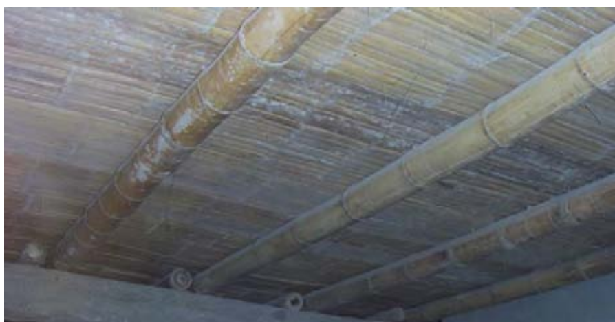
En este techo se observa las cañas guayaquil y encima la caña chancada
