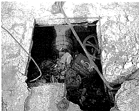
送水管分岐部 (カバー外されゴミ捨場)
