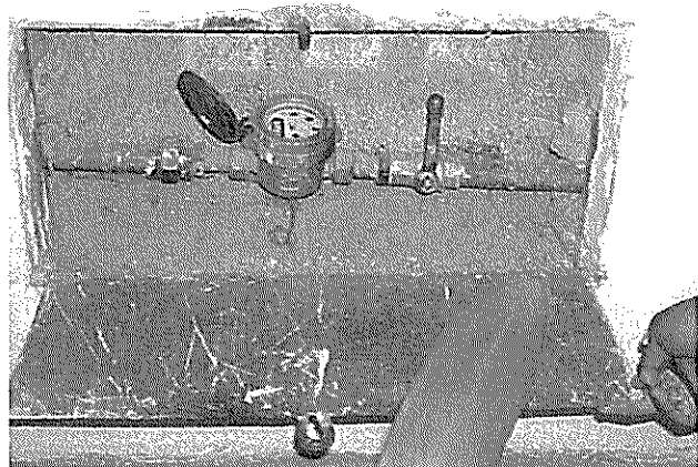
一般家庭の給水メーター (アソマダ町)
