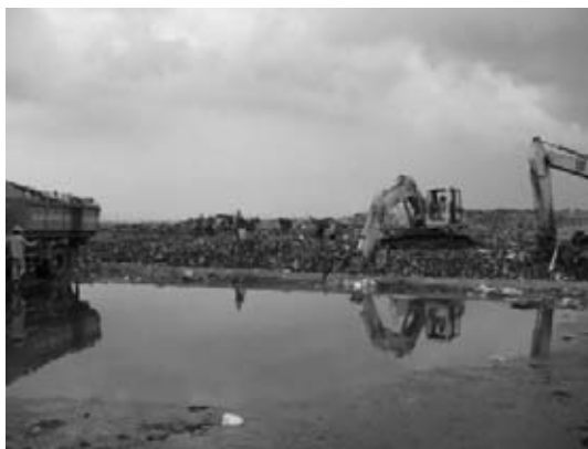
ごみ投入プラットフォーム
