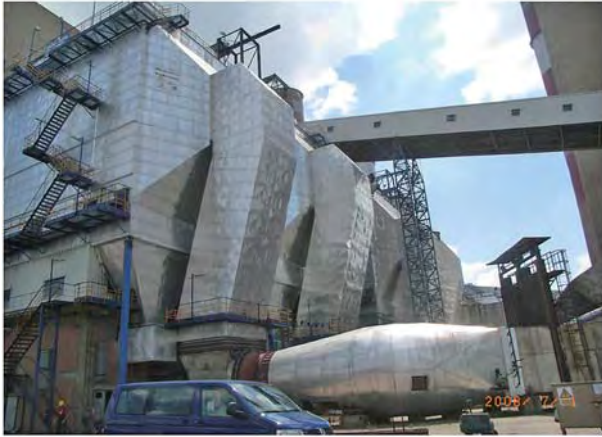
図8 最近、更新したEP（電気集塵）
