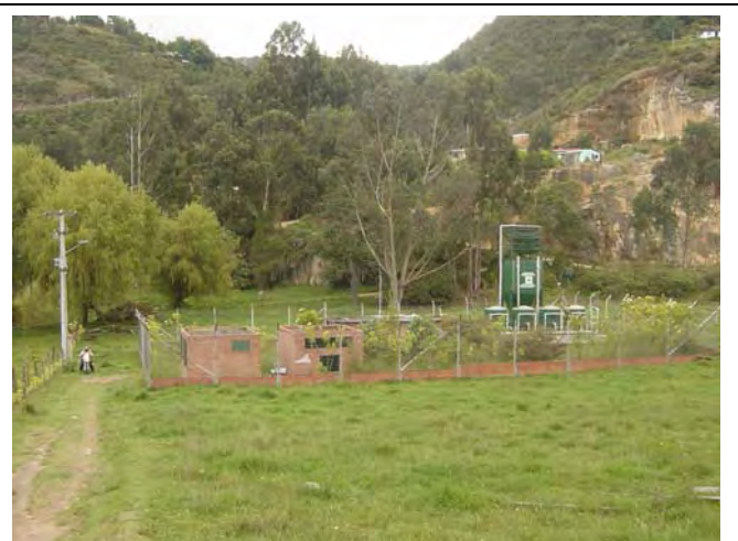
Instalación para tratamiento de agua subterránea en Tocancipa. Las instalaciones propuestas para tratamiento en este Estudio JICA son más compactas que ésta.
