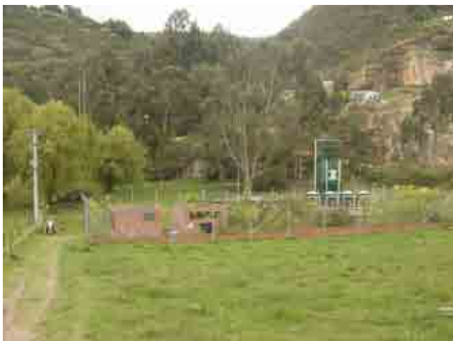
Tocansipa の地下水を水源とする水処理施設の例。提案している施設はこれよりコンパクトである。
