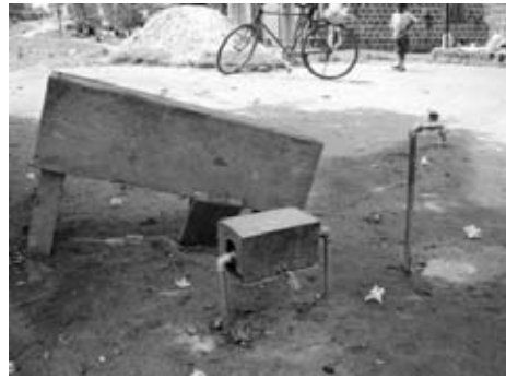
庭型水栓 (Yard Tap) (Mukono 県 Nakifuma 町)
