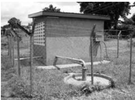
水源の揚水ポンプ場 (Mukono 県 Nakifuma 町)
