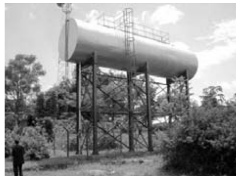
配水タンク (Mukono 県 Nakifuma 町)
