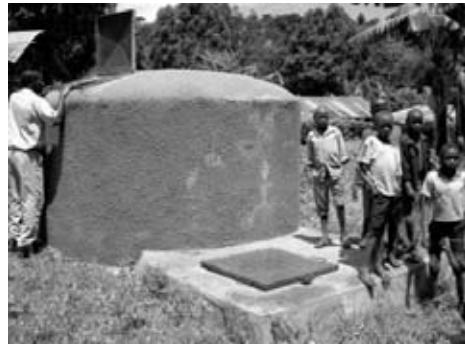
配水タンク（Kapchorwa 県 Kokwobutaki 村）
