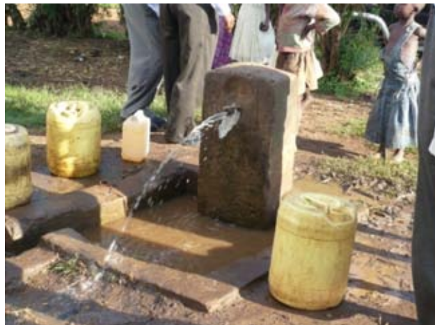
写-22 : Buyaga Centro Gravity Scheme Committee 運営の公共水栓 (写-19 の滝壺から取水し、無処理で 26 箇所の公共水栓に重力配水)
