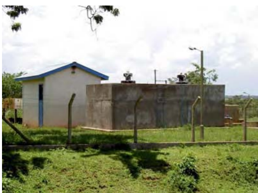
写-80 : Kayunga Town の水道施設の浄水場（デンマークの援助、井戸では水量が得られなかったため川の水を水源としている）
