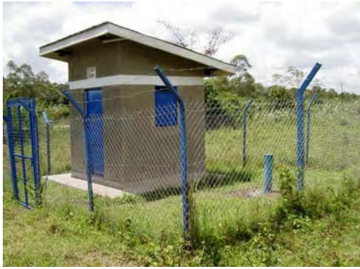
写-77 : Nakifuma Town の追加水源の深井戸と揚水ポンプ場（増設用に準備された井戸で、配電と配管は未設置）
