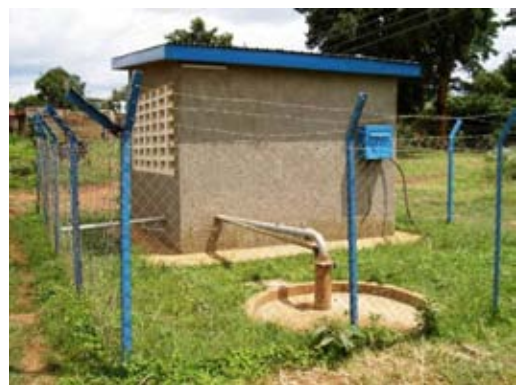
写-73 : Nakifuma Town の給水施設の水源深井戸 (深度 55m、揚水量 10m 3 /h、1 日 8 時間運転、電源は配電網、ハンドポンプの既存井を転用)
