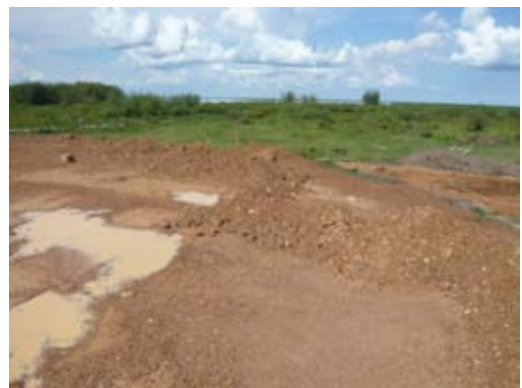
写-64 : Lwampanga の Fish Landing (チヨガ湖から水路を掘込み、漁船の船着場、魚市場、冷凍施設を作る計画。手前は魚市場用の盛土で、費用はアフリカ開発銀の融資。MOA が建設)
