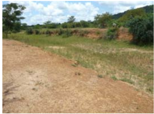
写-60 : 左岸側アバットの洪水吐(一度も使われたことがない)
