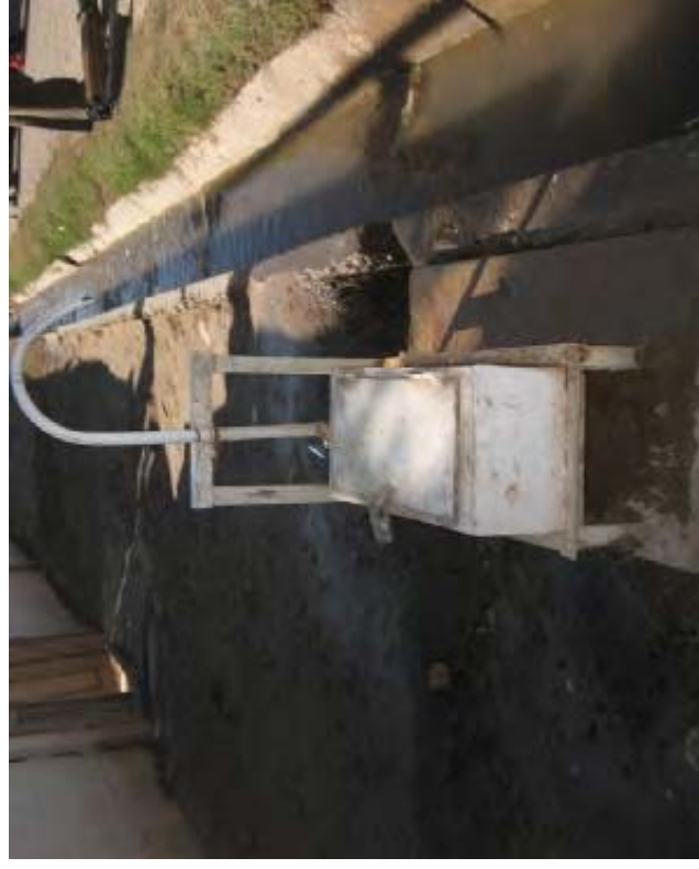
Фотография №1- Водопроводная колонка с водомерным счётчиком, отреабилитированной системы водоснабжения в к. Большевик Кабадёнского района Хатлонской области
