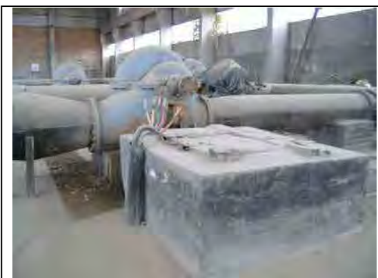
Головная Насосная Станция Бохтар
