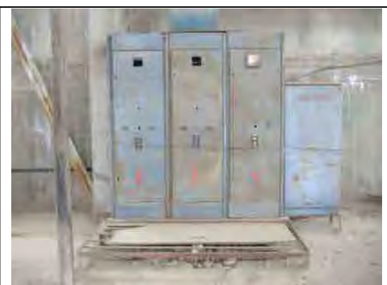
Панель управления насоса
