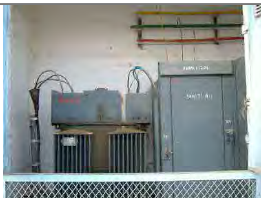
Входная панель и Трансформатор
