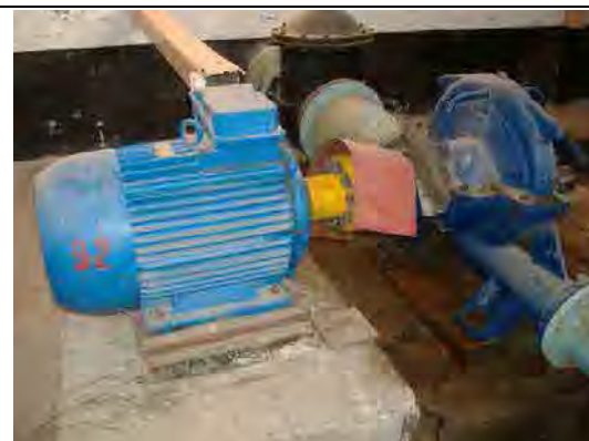
Насос на Новой Насосной Станции
