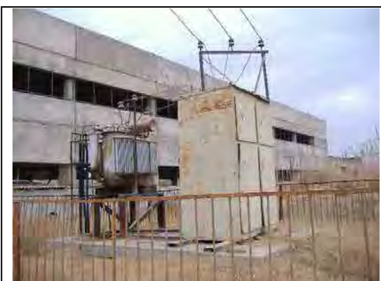
Панель управления и Трансформатор
