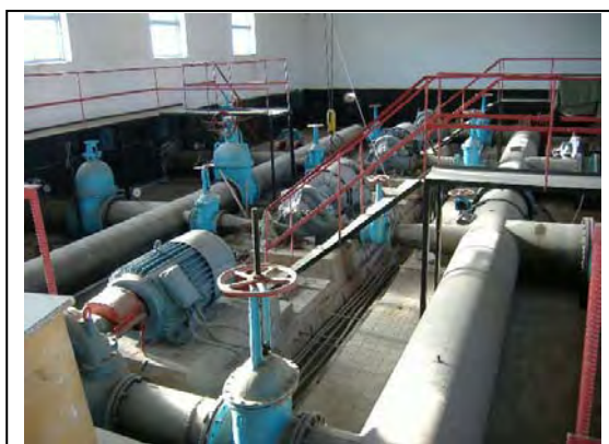
Насосная Станция Узун
