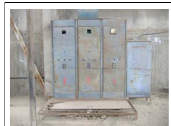
ポンプ制御盤
