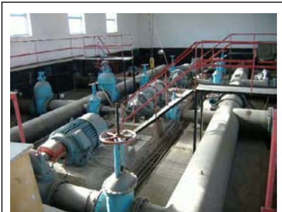
ウズンポンプ室
