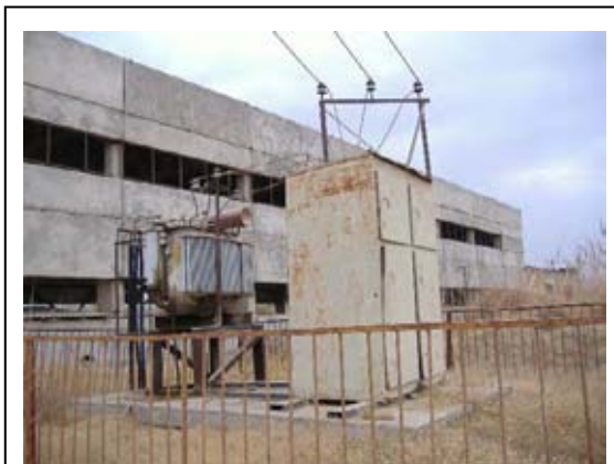
受電盤と変圧器
