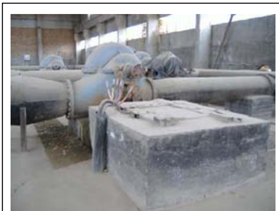
ボフタールメインポンプ場
