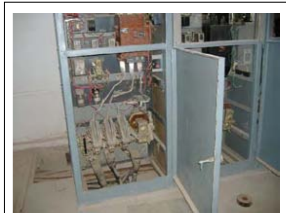
ポンプ制御盤
